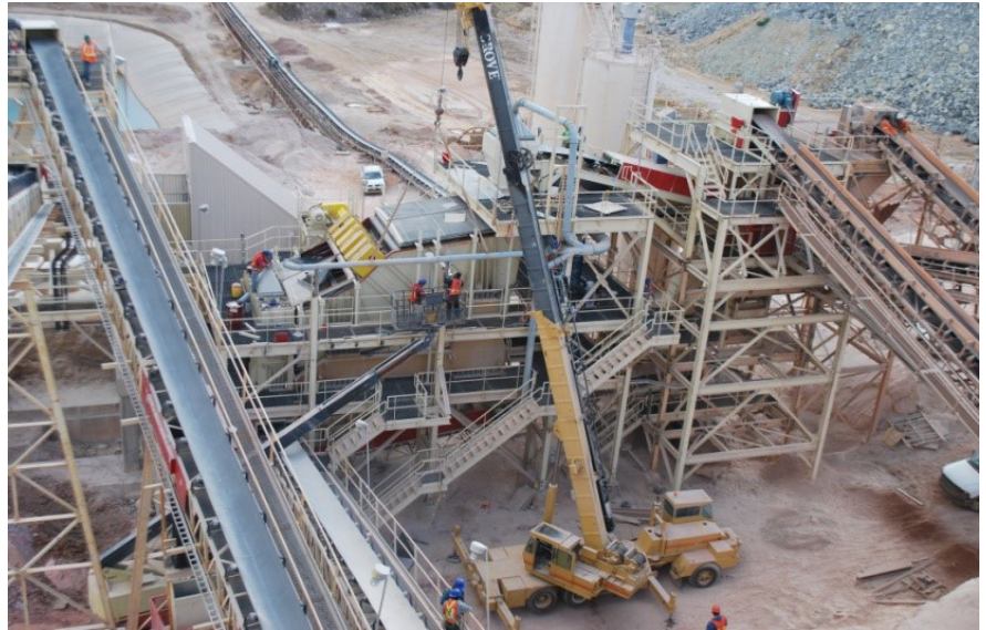
Instalación de una Chancadora de Cono y Sistema de Clasificación para Producir un Producto Final a un Tamaño de Partículas a 80% Menos 9mm. Proyecto Ejecutado en una Mina en México cuyo proceso es Lixiviación de Mineral Aurífero en Pilas.
